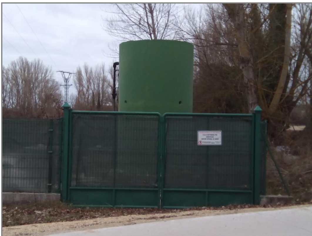
Fotografía A-6. Instalación depuradora de agua junto al río Ausín o de los Ausines en Olmosalbos.
